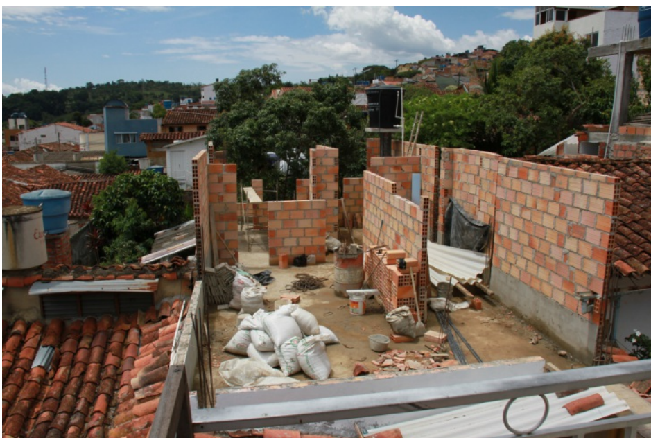
Bild 2 von 2 von Wichtige Baumaßnahmen Fototitel: Baumaßnahmen Foto 2 Datum: Montag, 24.08.2020 Firma: Firmenname 14 Putzarbeiten
