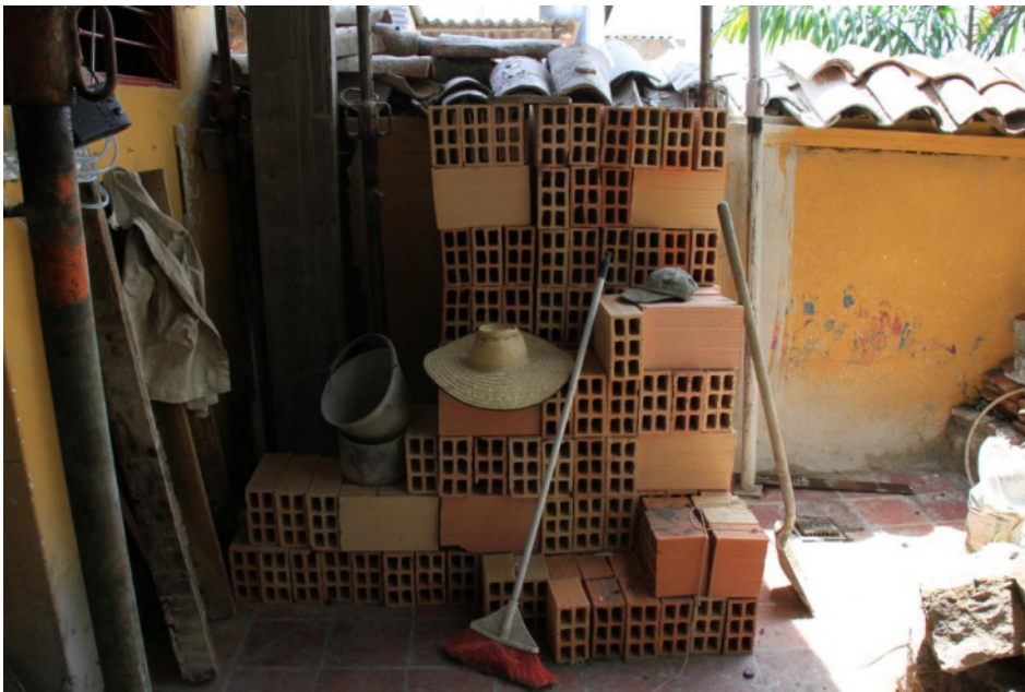
Bild 1 von 1 von Behinderungen Fototitel: Behinderungen Foto 1 Datum: Donnerstag, 24.09.2020 Firma: Stein und Bein GmbH Gelagertes Material behindert Schlosser
